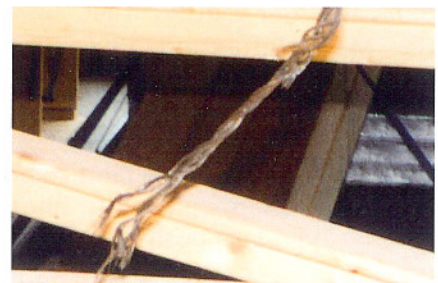
Unfallbeispiel: Dieses gerissene Kranseil führte in einem Betrieb zum Absturz einer Last, die eine Person tödlich traf.
